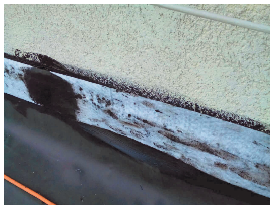
Obr. č. 5 Izolácia ukončenia nakotvenej membrány a fasády priľahlej budovy, geotextília a ALF HB500
