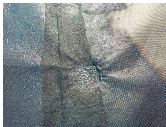
Obr. č. 18 Nesprávne zatesnená kotva geotextiliou
