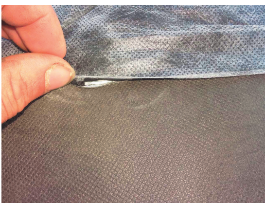
Obr. č. 17 Nesprávne zatesnená kotva páskou
